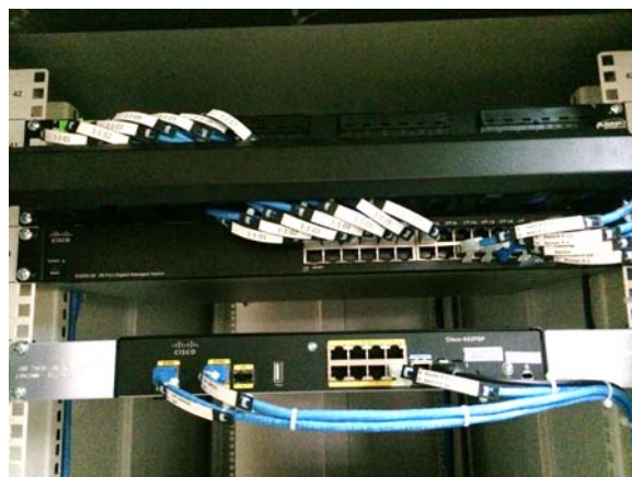
Switch Cisco SG300-28 และ RouterFirewall Cisco C892FSP
