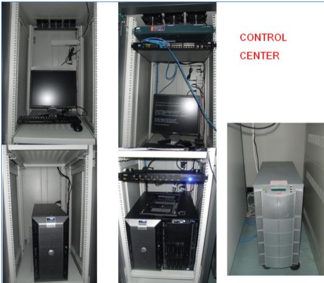
ภาพที่ ๒ - ๔ แสดงอุปกรณ์ที่ติดตั้งในสถานีควบคุม (Control Station)
