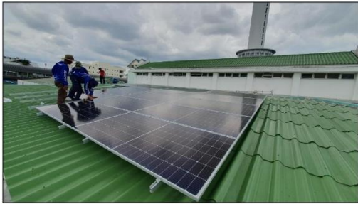
ติดตั้งระบบผลิตไฟฟ้าพลังงานแสงอาทิตย์ที่ติดตั้งบนหลังคา (Solar Rooftop)
