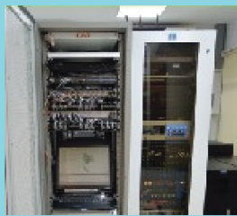
ศูนย์ควบคุม (Control Center)
